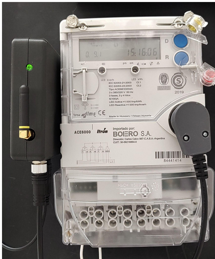
Figura 2 - Sistema conectado a medidor trifásico
